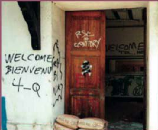
La porta de l'edifici del Roc de les Anelles havia estat forçada i "decorada".
