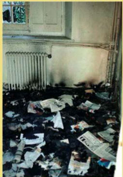
Restes deixades pels ocupes a les instal·lacions.
