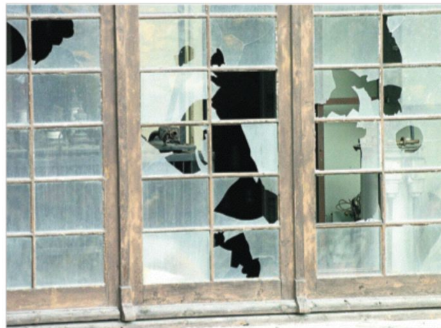
Detall de l'edifici de l'antiga Radio Andorra que es troba força deteriorat.
